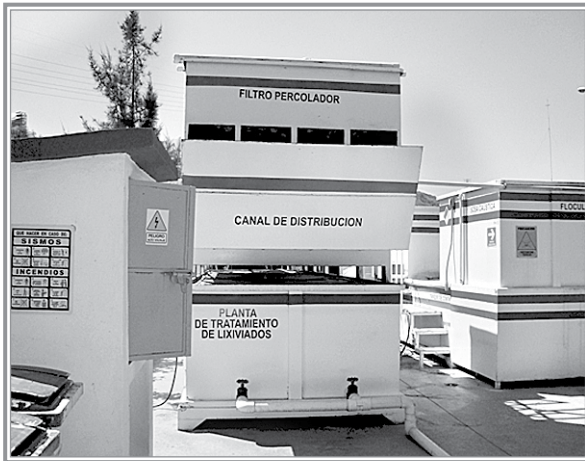
Figura 7 ■ | Planta de tratamientos de lixiviados del RS de Tlalnepantla.
