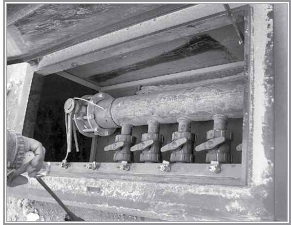
Figura 15 ■ | Sistema de conducción de biogás (cabezal con 8 líneas).
