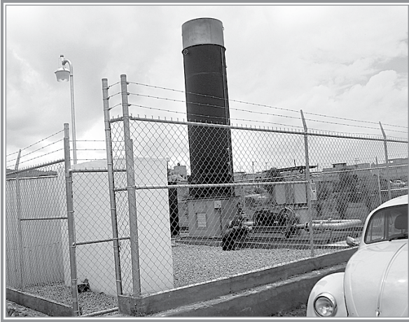
Figura 14 ■ | Sistema de quemado de biogas.
